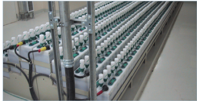
Sistema de batería estacionaria FNC®
